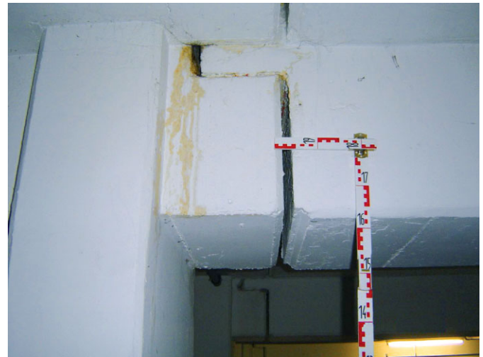
Bild 1. Tiefgarage: Wasser läuft aus den Dehnfugen
